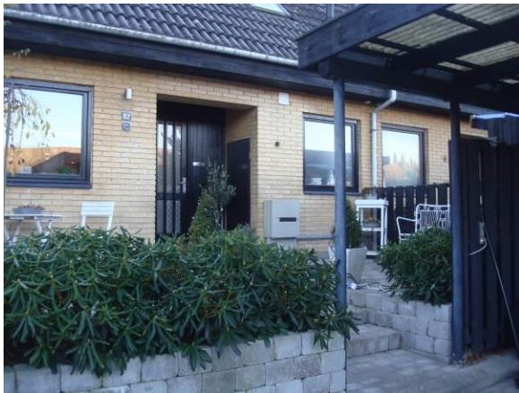
Foto nr. 7 – højde forskel fra vej til fortov, ledninger ligger dybt ift. murgennemføring
